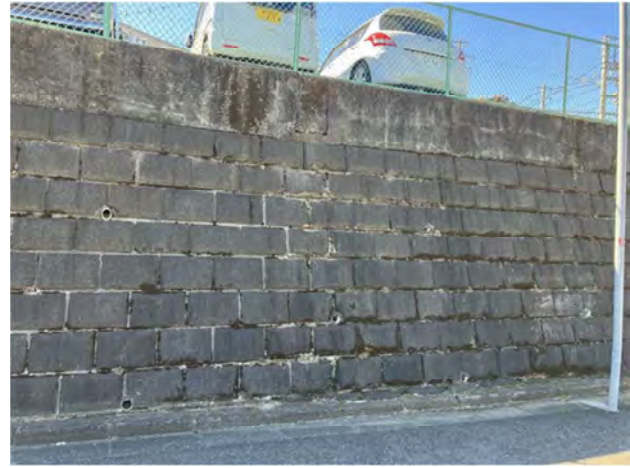
擁壁中央部目地沿いの亀裂
