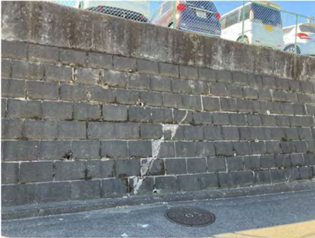
擁壁中央部斜めの亀裂
