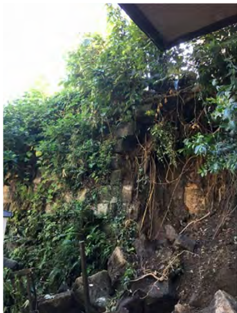
崩落部正面(ローム層の露出)
